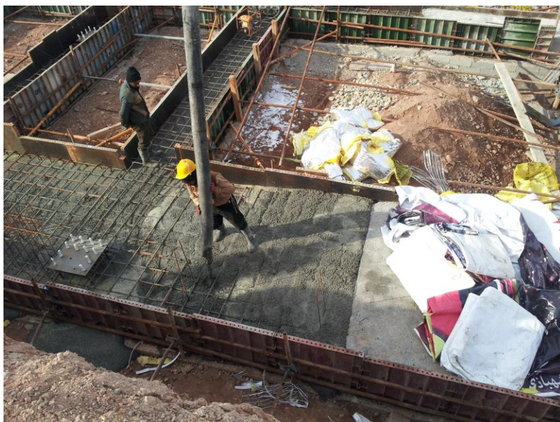
عملیات بتن ریزی پارت اول فونداسیون نواری سازه پارکینگ (حجم بتن حدود ۱۶۰ متر مکعب)
